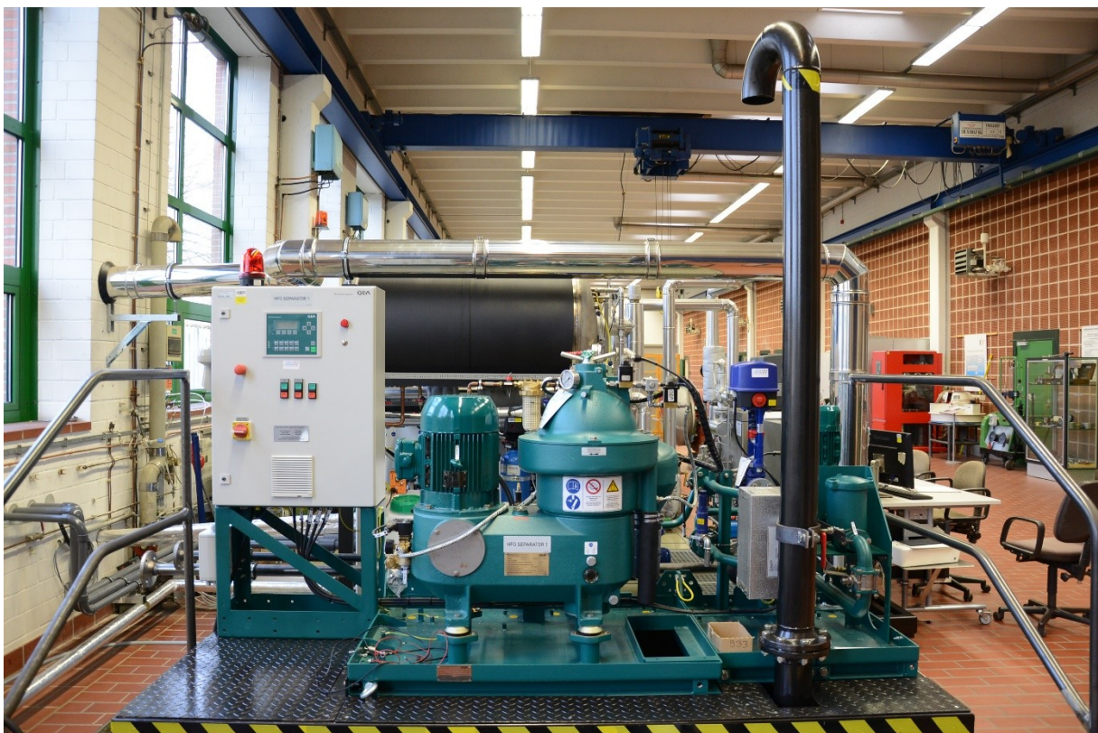
Separatoranlage OSD 18 in der Maschinenhalle der Hochschule Flensburg
